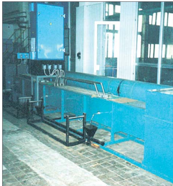
Рис. 3. Опытно-промышленная станция УФ-обеззараживания на Курьяновских очистных сооружениях
