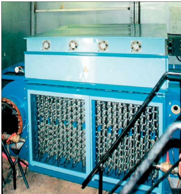
Рис. 1. Опытно-промышленная станция УФ-обеззараживания на очистных сооружениях Зеленограда
