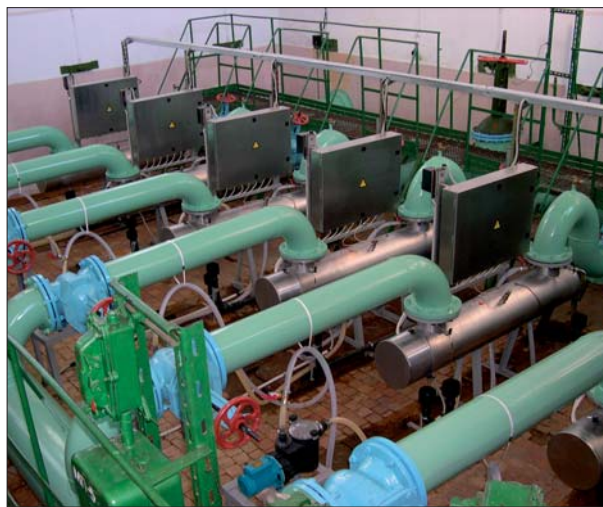
Рис. 5. Станция УФ-обеззараживания подземной воды в г. Новокуйбышевске
